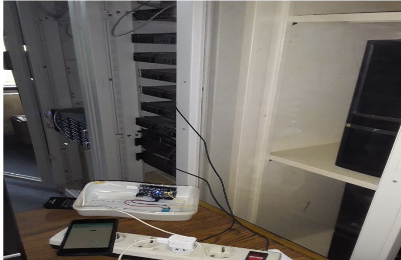
Gambar 3. Implementasi detektor di ruangan server SIU
